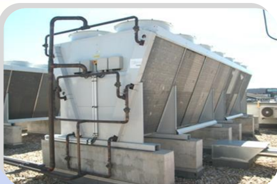
Condensation par aérocondenseurs
