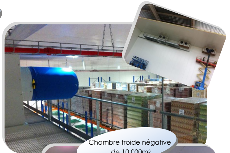
Chambre froide négative de 5 000m 3
