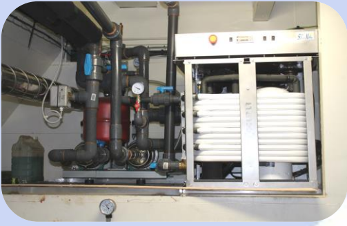
Groupe eau glacée sur Frégate HERMIONE (17)
