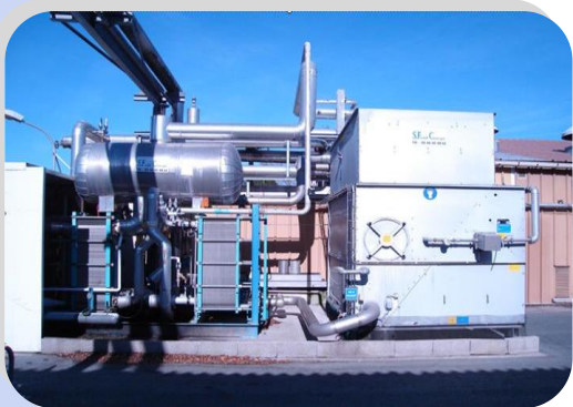
Production Alkali par du NH3 à -8°C sur bac à glace
