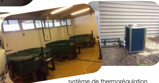
système de thermorégulation de bassins d'eau de mer École nationale vétérinaire de Nantes Oniris (44)
