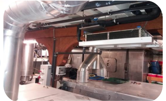
avec réseau de ventilation forcée et extraction
