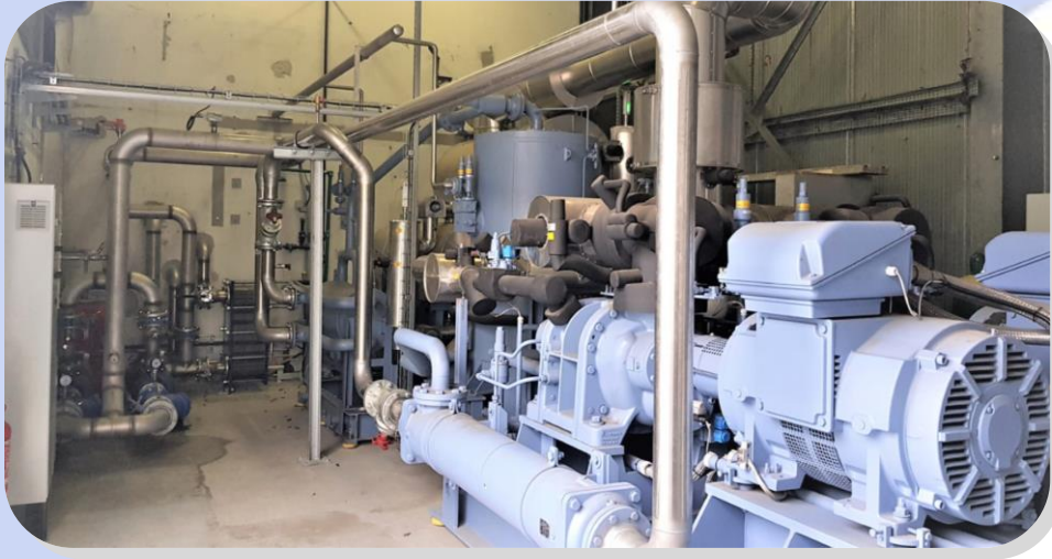
Production 550kW NH 3 -alcali -40°
