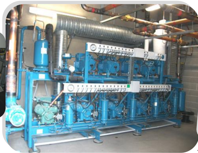
Production en boosters semi-hermétiques avec variateur de vitesses 30/70Hz sur l'étage MP
